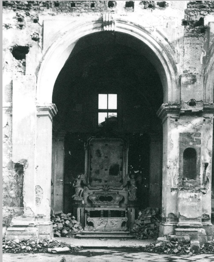
Aspetto dell'interno della chiesa dopo i danni del bombardamento (particolare)
